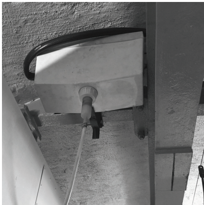
Obr. 1: Potřebovali jsme něco, co by nám poskytovalo konstantní průtok vody
